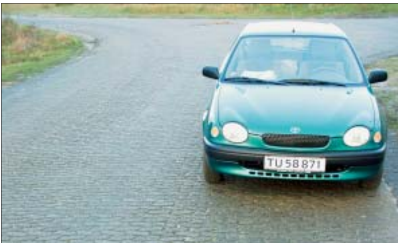
Figur 2.40. Militærareal med 30 år gammel kørevej med belægningssten. Udsættes dagligt for intensiv kørsel med bæltekøretøjer. Skønnet restlevetid ca. 20 år, som er bestemt af slidpåvirkningen fra bæltekøretøjerne
